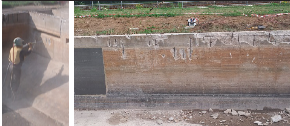
Sandgestrahlte Fläche, loser Beton bröckelte ab
